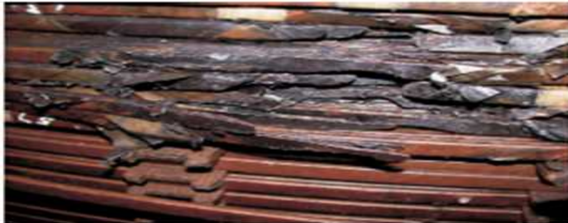
[그림 2-9] 2003년 할로윈 스톰 당시 남아공의 변압기 파손
